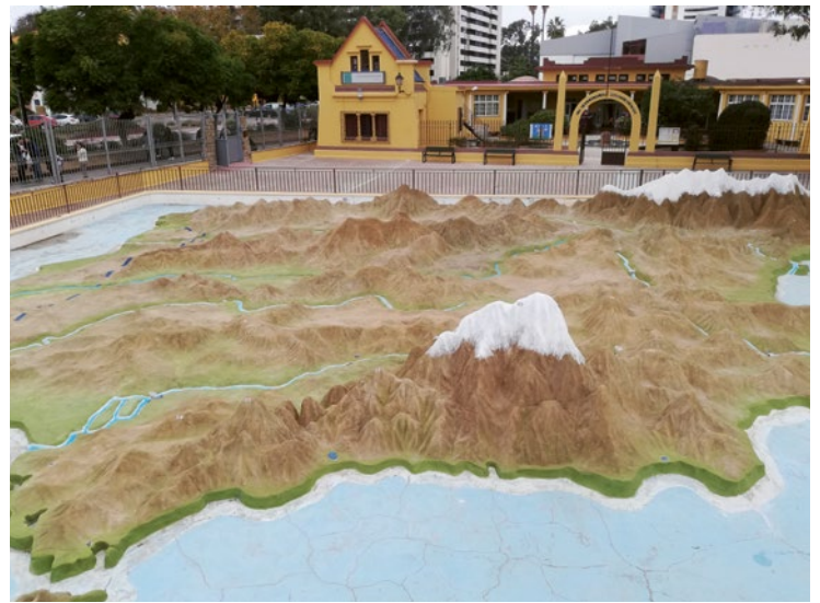
FIG. 8. VISTA GENERAL DEL MAPA TRAS LA INTERVENCIÓN, A EXCEPCIÓN DE LOS MARES, DONDE TODAVÍA SE APRECIAN FISURACIONES.
